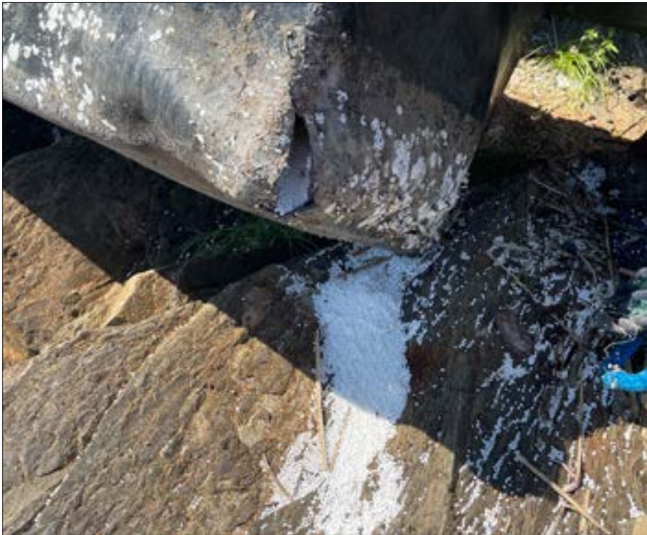
LEKKASJE Plastbeskyttelsen på en flyter til en flytebrygge har sprukket og isoporkuler lekker ut.
