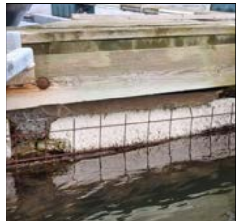
ÅPENT I SJØ Fortsatt har mange flytebrygger flytere med ubeskyttet EPS.
